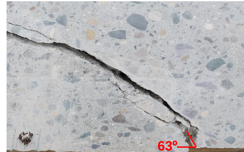
Разрушения бетона в окрестности опоры
