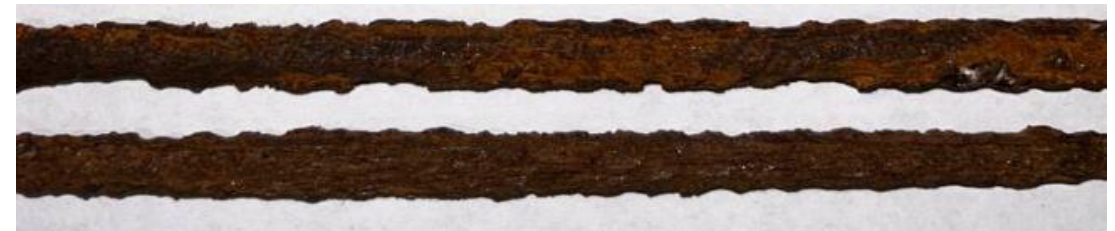
Арматура после коррозии
