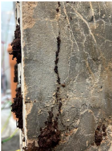
Коррозионные трещины в колонне
